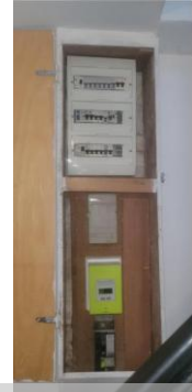
Fils électriques sécurisés
